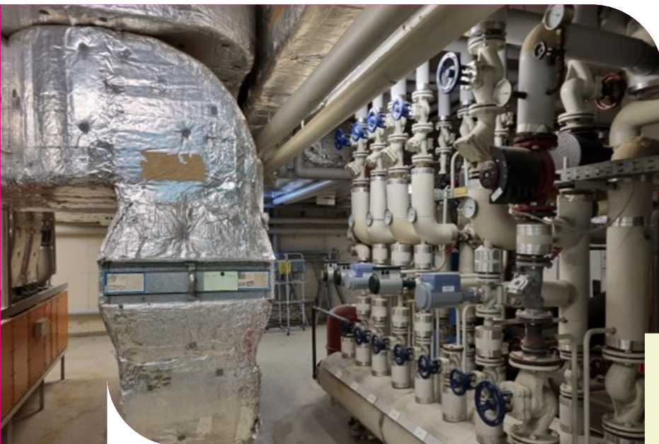
Abb. 10: Heizungsanlage des Wikinger Museums Haithabu
